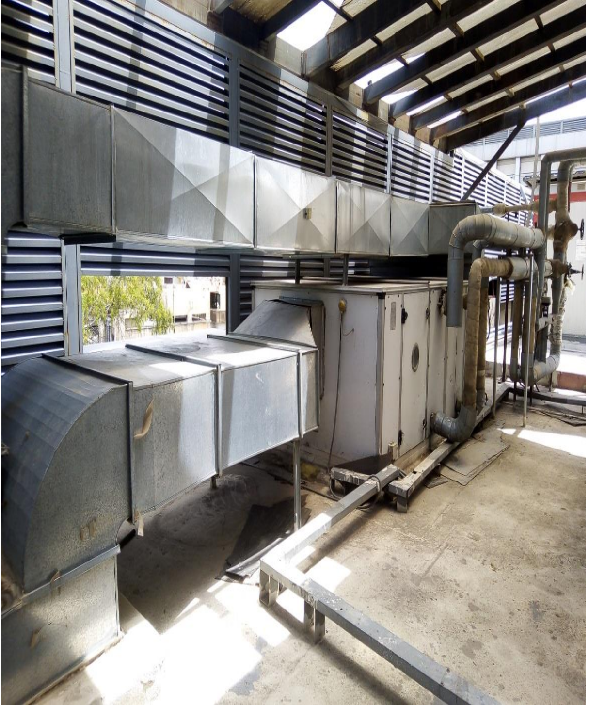
الشكل (3-2) وحدة معالجة الهواء في مشفى التوليد الجامعي AHU
