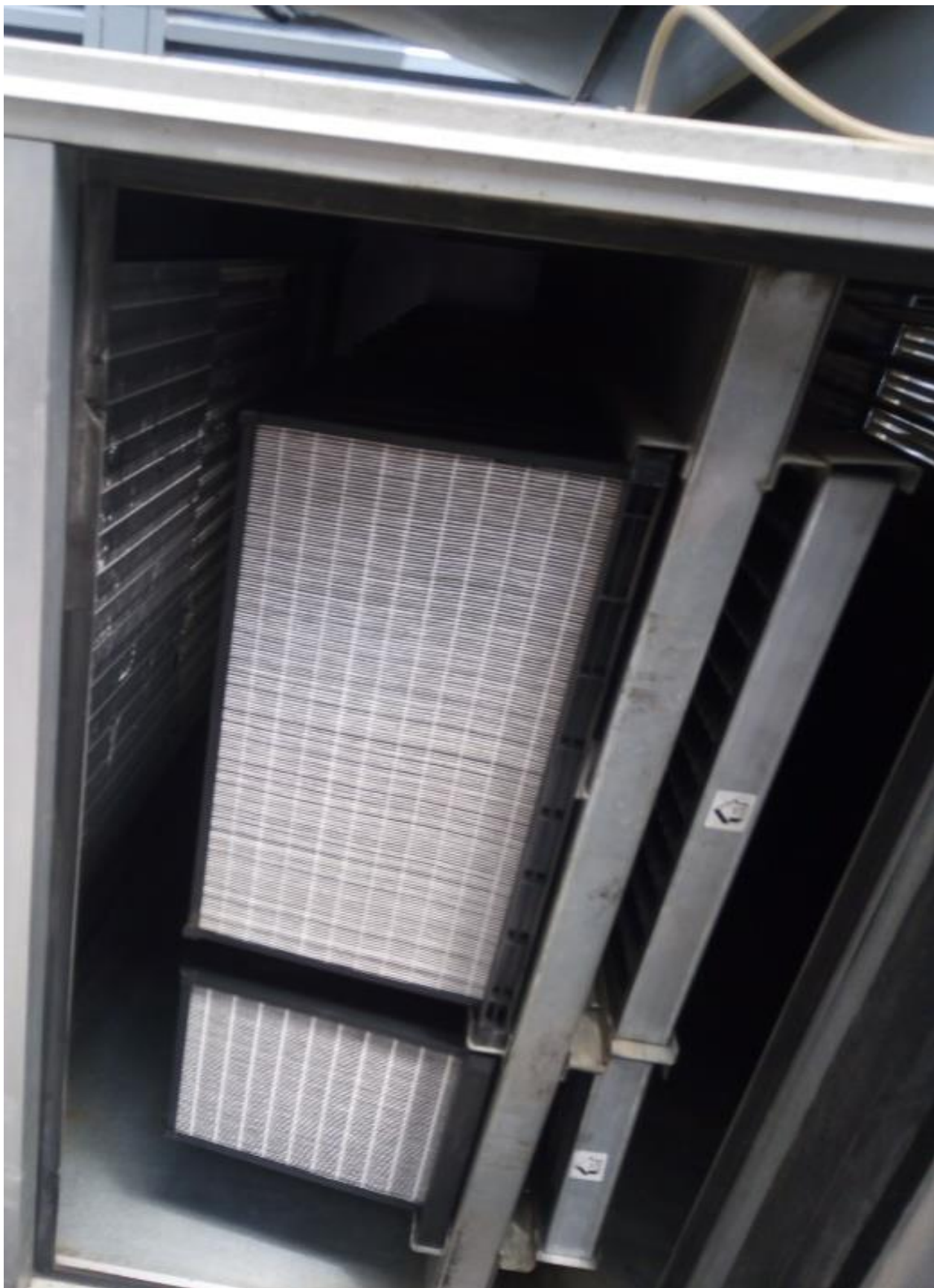
الشكل (5-2) الفلاتر في وحدة معالجة الهواء AHU في مشفى التوليد الجامعي
