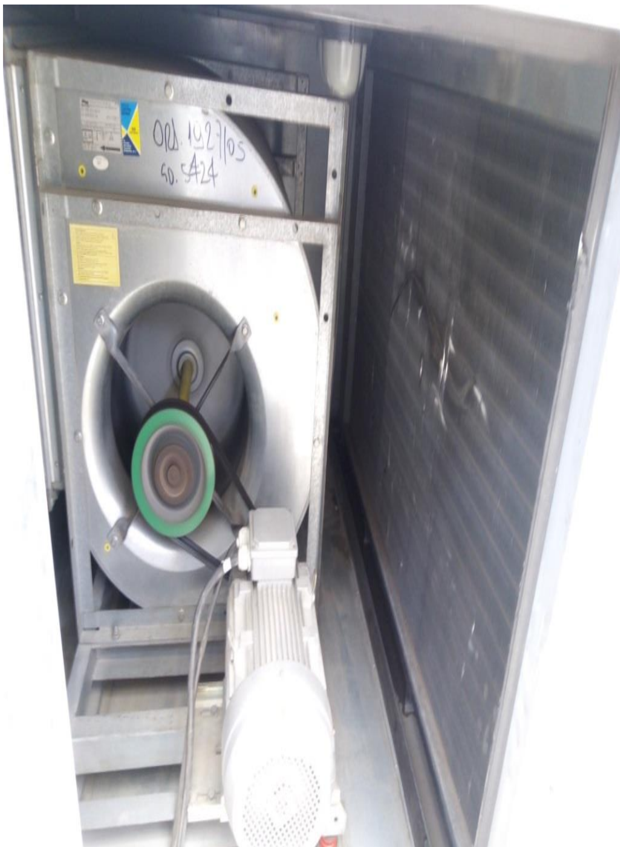
الشكل (4-2) المبادل الحراري ومروحة السحب في وحدة معالجة الهواء AHU في مشفى التوليد الجامعي
