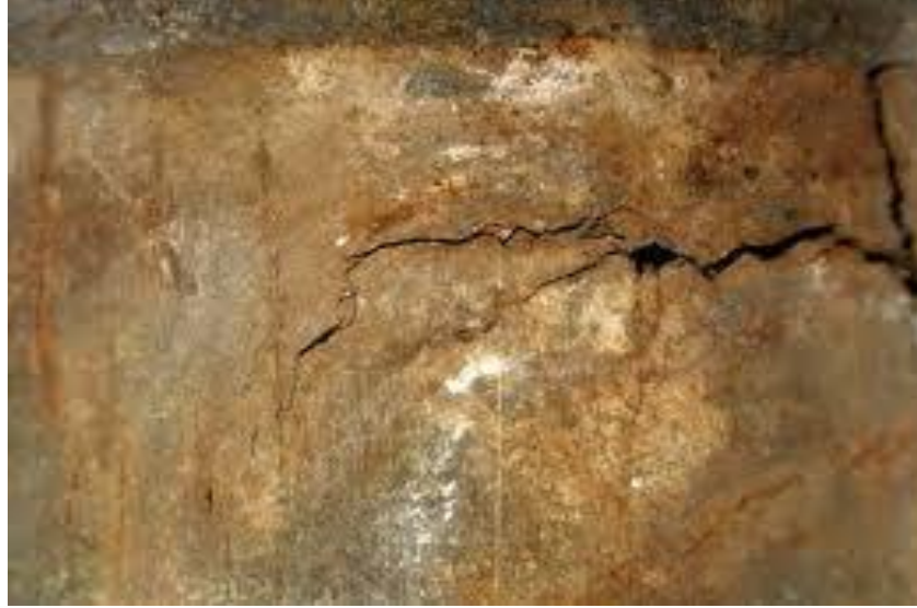
الشكل (3-6) التآكل الإجهادي
