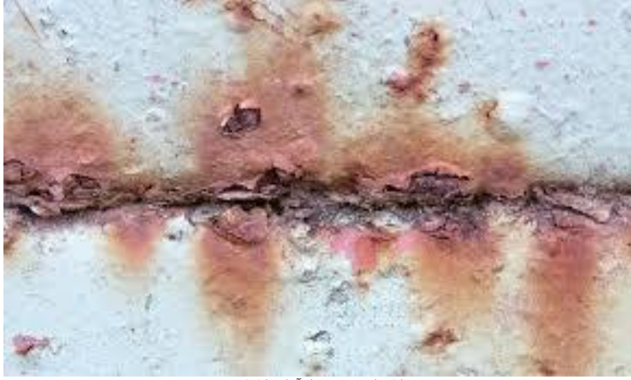
الشكل (3-2) التآكل الشقي
