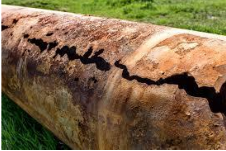
الشكل (3-12) التآكل الميكروبي
