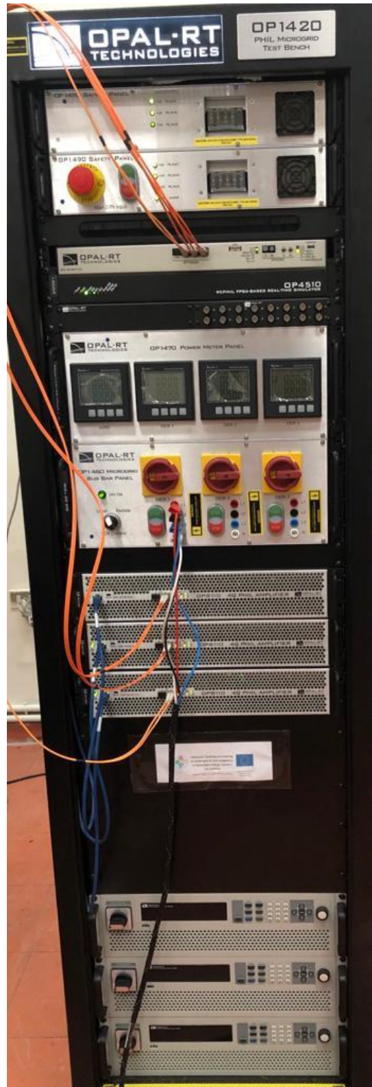
الشكل (5 - 25) صورة واجهة منصة RT-LAB.
