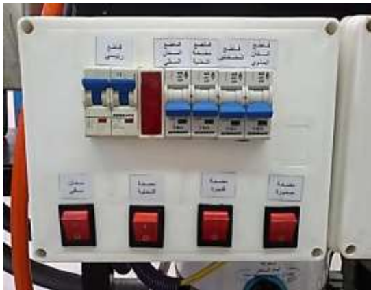
الشكل (i-3-3) لوحة القواطع الكهربائية
