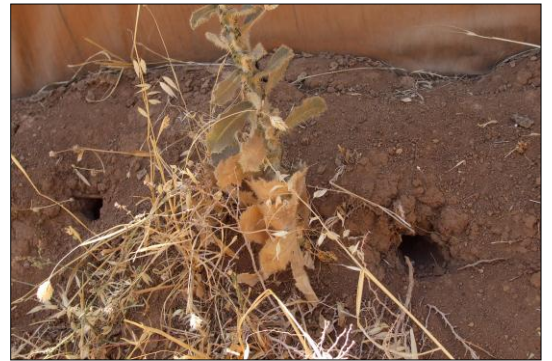
الشكل (7) الجحور التي تتسرب من خلالها مياه الأمطار
