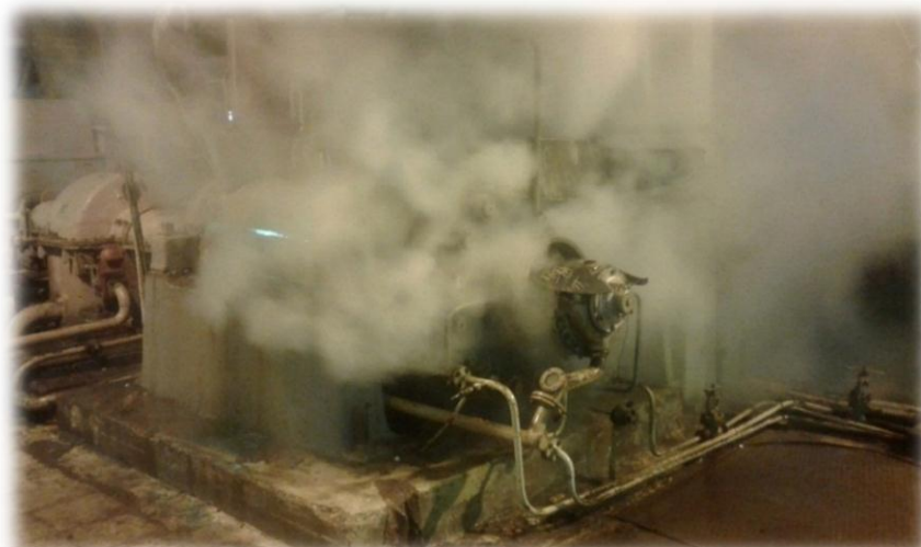
الشكل (5.4) اهتزاز في مضخة تغذية المرجل وانخفاض في التدفق
