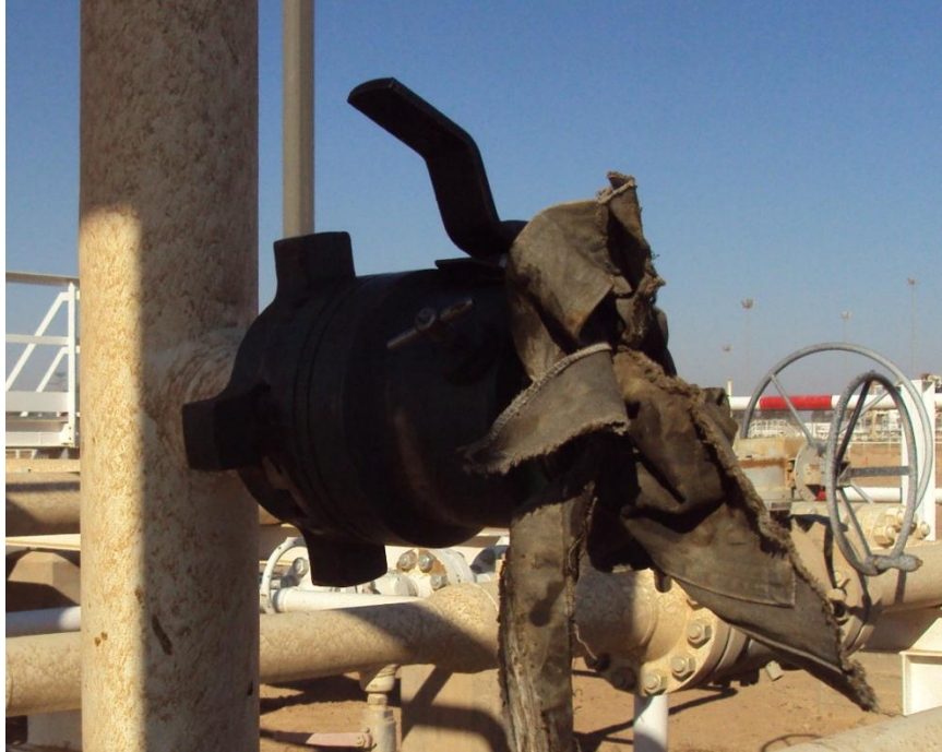
الشكل (10.3) صمام الإقفال يقفل خط النفط.
