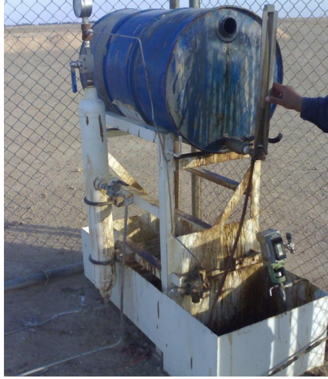
الشكل (31.4) تجهيزات حقن مضاد التآكل.
