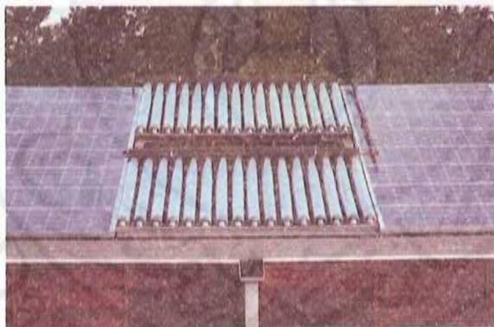
الصورة (78) أنابيب مفرغة كمجموعات للطاقة الحرارية الشمسية محاطة بألواح ضوئية منصوبة على السقف
