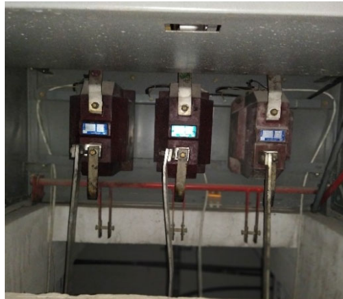
الشكل (4- 5): صورة لمحولات التيار المستخدمة في المحطة
